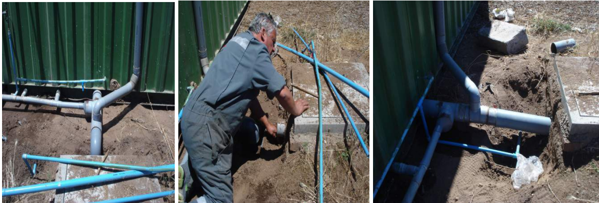
Se Observa los trabajos de conexión a red de agua potable y de descarga de aguas servidas a fosa séptica
